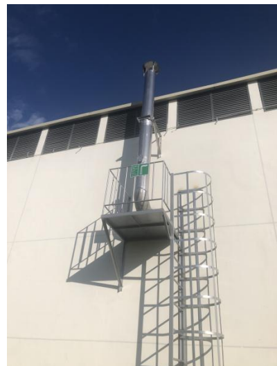
备用发电机废气排放口
