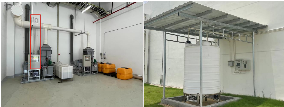
真空回流焊工序喷淋废水收集管道及收集桶
