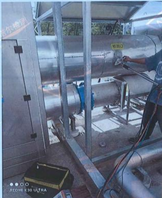
粉体清漆涂补废气处理前采样口
